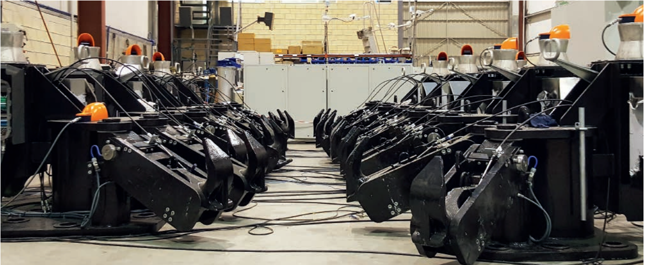
Quick Release Hooks at Prosertek plant. Ganchos de Escape Rápido en las instalaciones de Prosertek.
