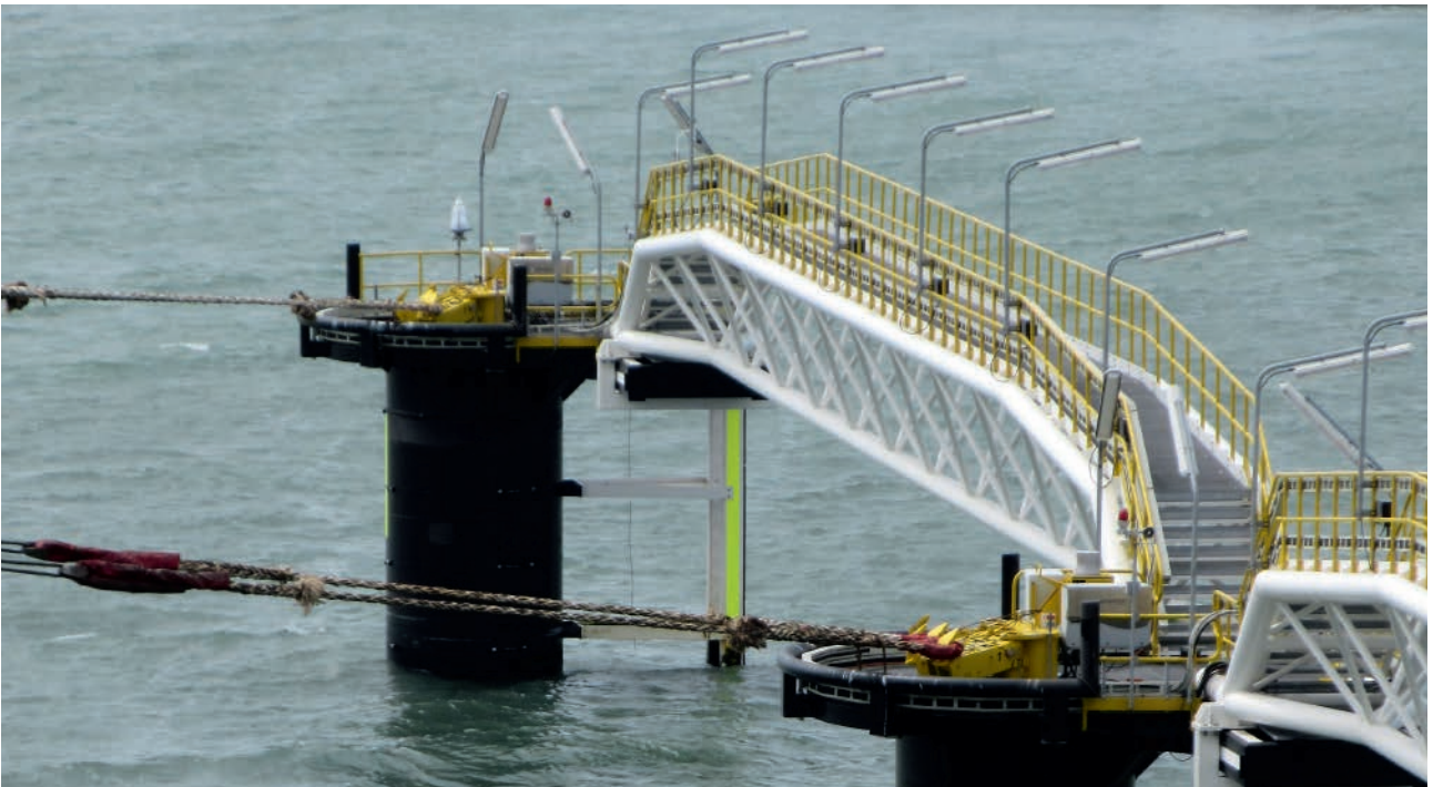
Quick Release Hooks installed by Prosertek. Ganchos de Escape Rápido instalados por Prosertek.
